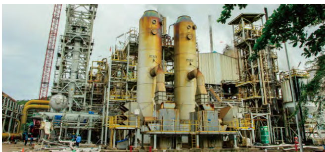
Project Name : PTIP PTA PLANT MODIFICATION Client Name : PT Indorama Ventura Tonnage : 450 MT Location | Year : Cilegon, Banten - Indonesia | 2015
